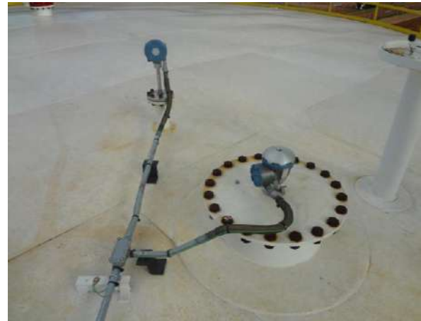
Telemetria em tanques
