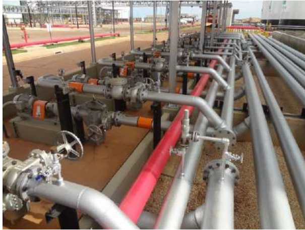
Pátio de Bombas
