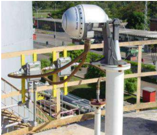
Telemetria em tanques
