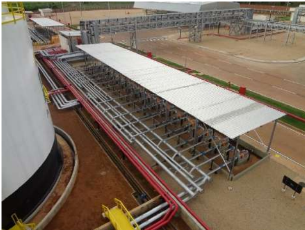
Pátio de Bombas
